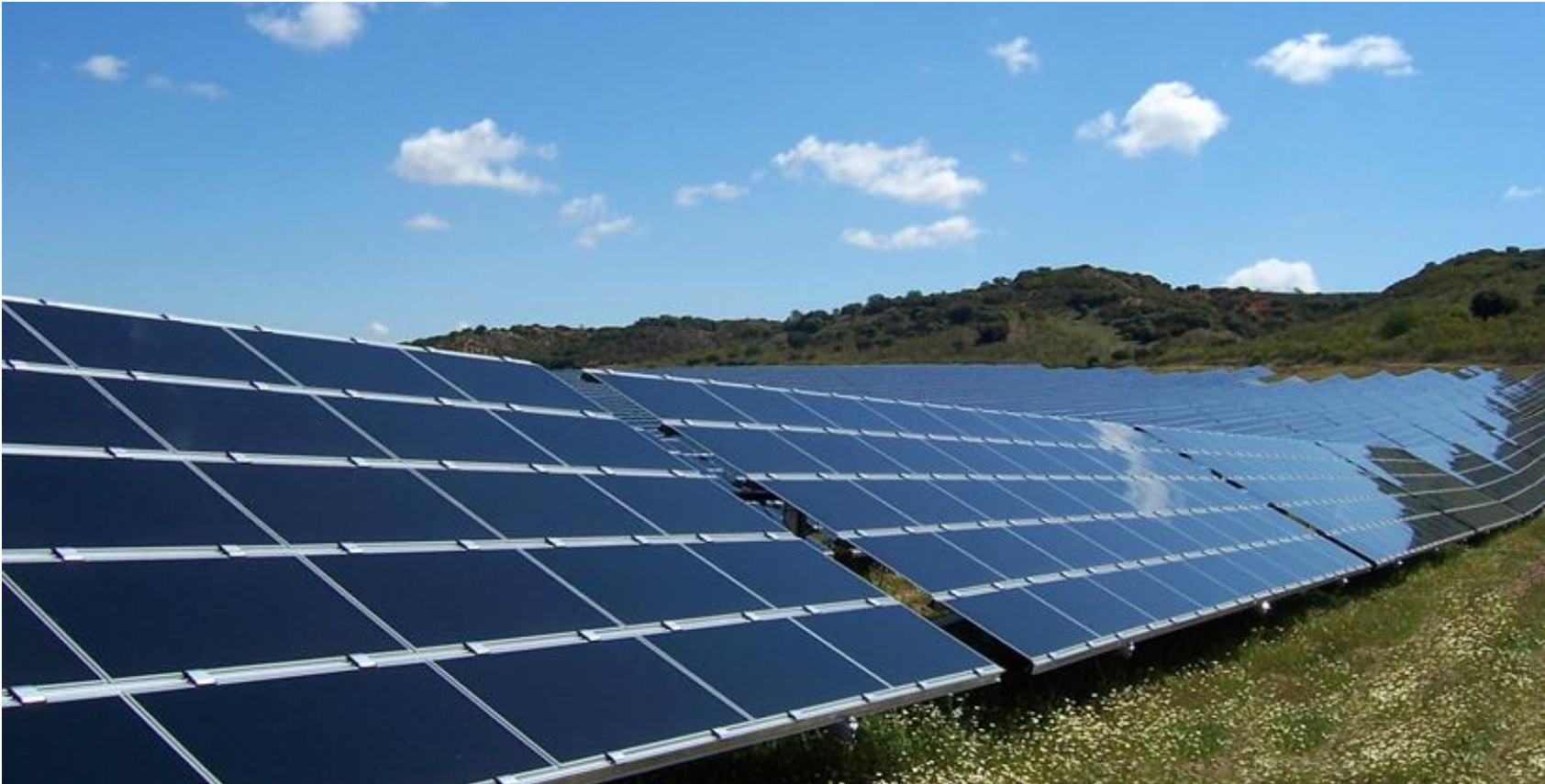
Parc photovoltaïque EDF Renouvelables de Narbonne
